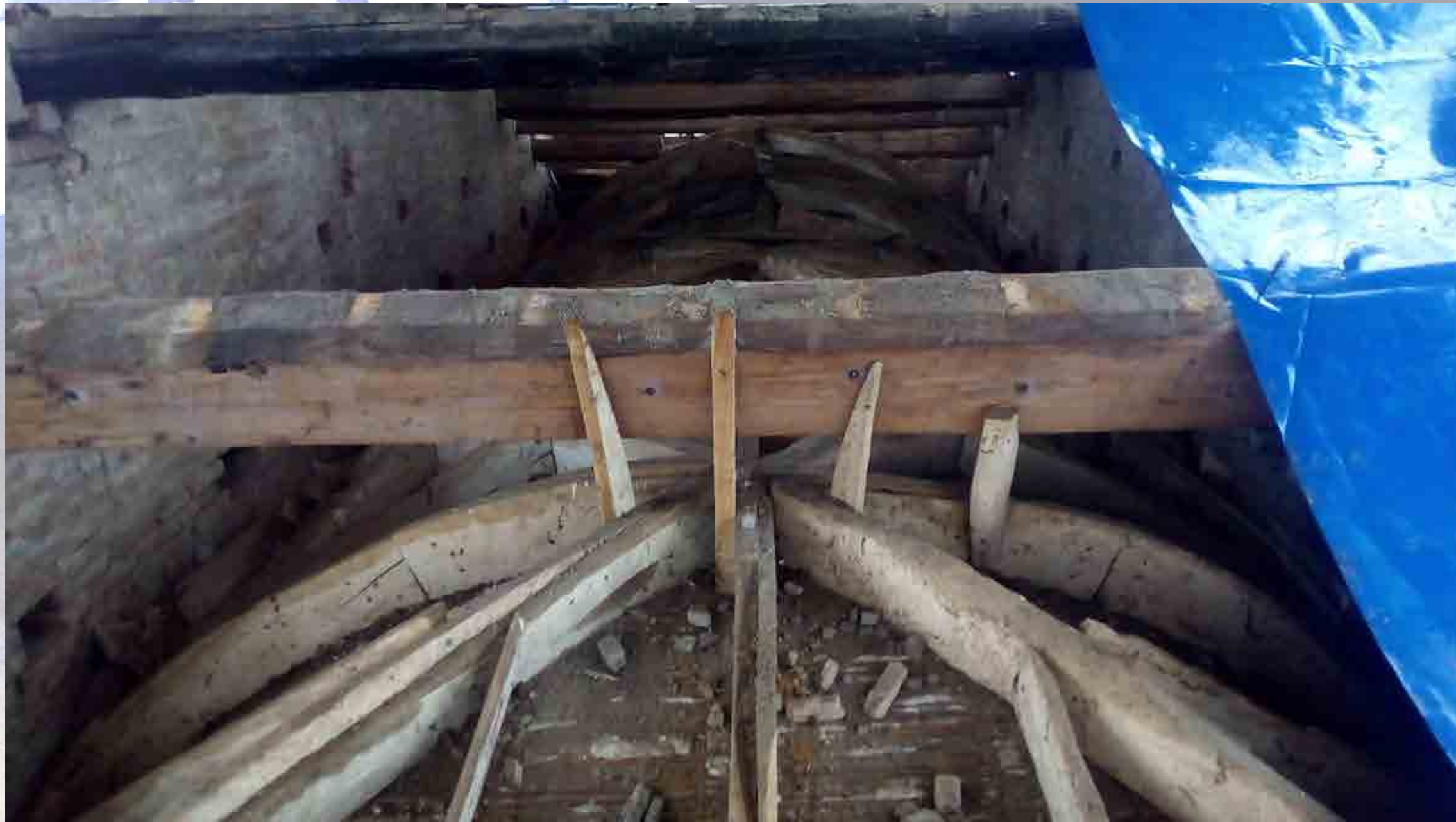
dettaglio del sottotetto dove è visibile il degrado delle strutture e la grande presenza di guano di piccione
