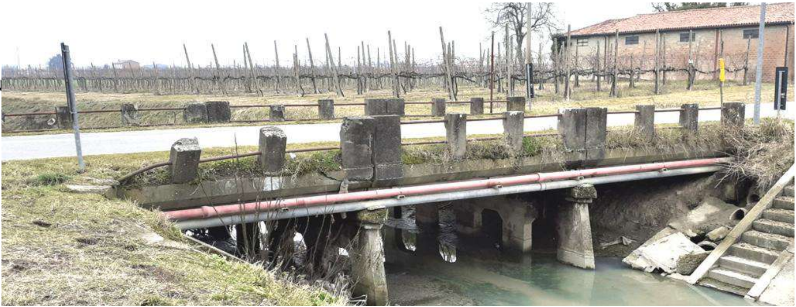
Via Spinazzino Barriere Bordo Ponte
